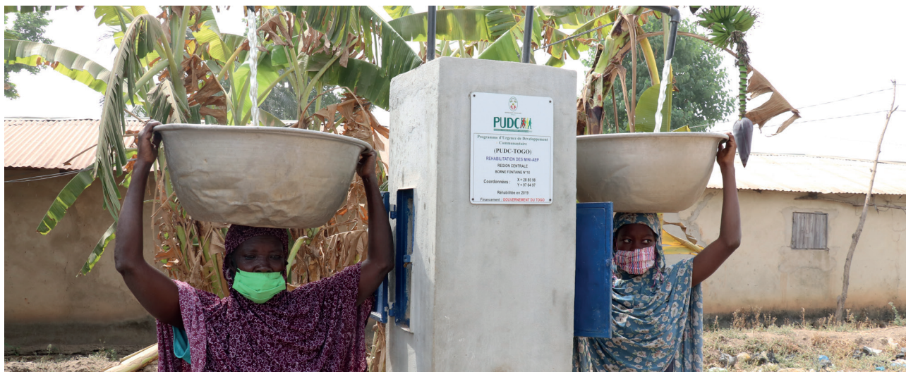
Une borne fontaine réalisée dans la région centrale par le Programme d'Urgence de Développement Communautaire (PUDC)
