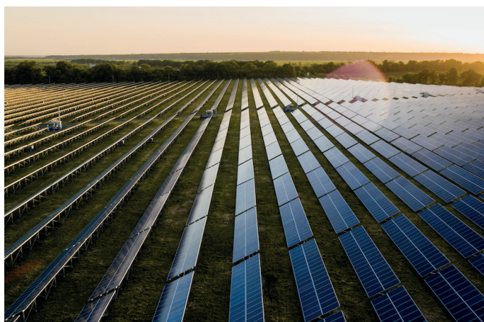
Centrale photovoltaïque de Blitta
